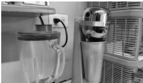
Figura VIII.14 Aparatos eléctricos conectados a un mismo tomacorriente.
