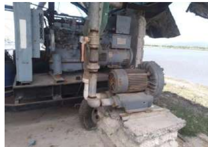
d). Generador eléctrico industrial
