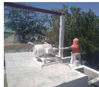
c). Sistema de bombeo a base de motor eléctrico
