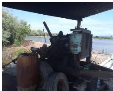
b). Sistema de bombeo a base de motor a Diésel
