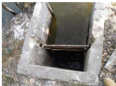
d). Compuerta de salida
