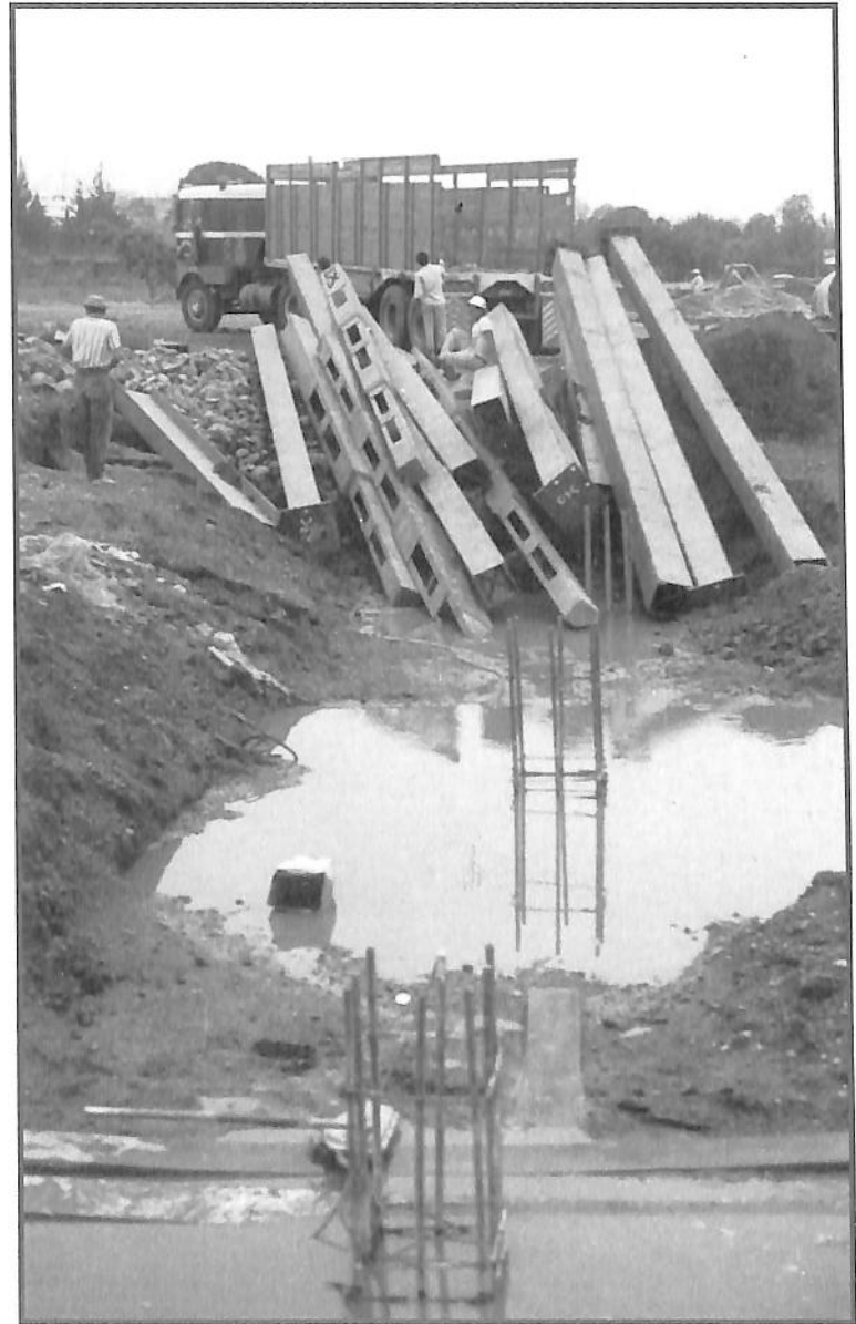
Edificio Torre de la Rectoría. Llegaron los elementos de la estructura metálica.
